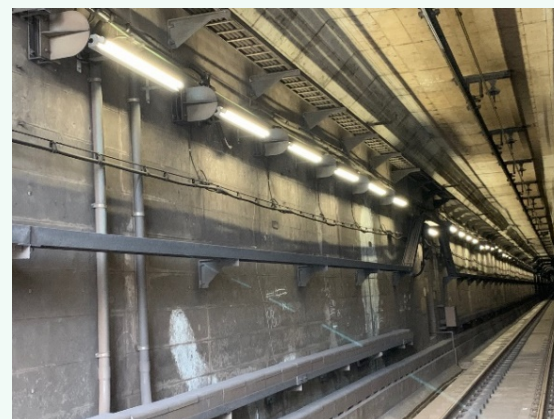
〈ずい道照明LED化〉
